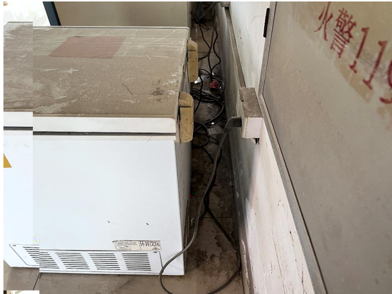
新楼四楼 电器线路杂乱
